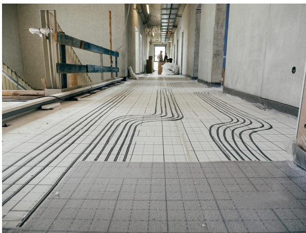
Bild 5: Anbindeleitung in Dämmebene
