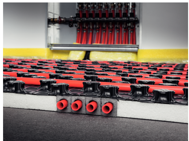
Bild 4: Anbindeleitung in Dämmebene
