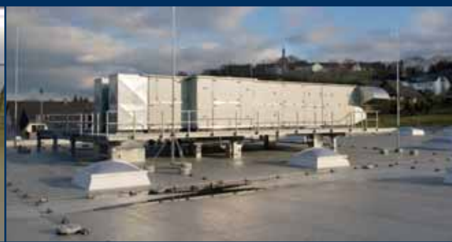
KLIMANAUT 60 – Aussenaufstellung auf Produktionsgebäude
