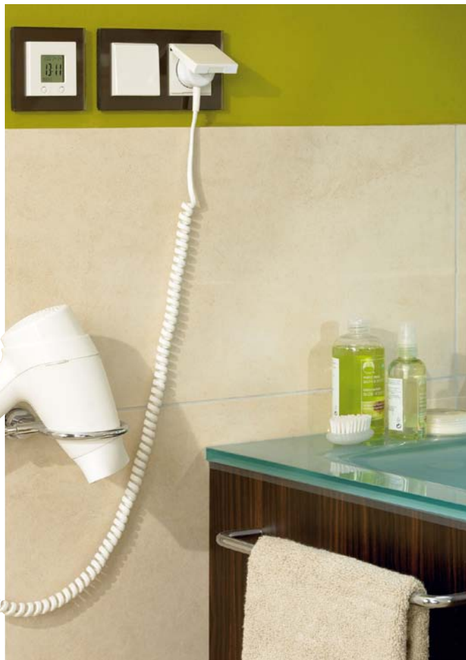
Eine ausreichende Anzahl an Steckdosen sollte dort platziert werden, wo elektrische Geräte wie Föhn oder Rasierer betrieben werden.
